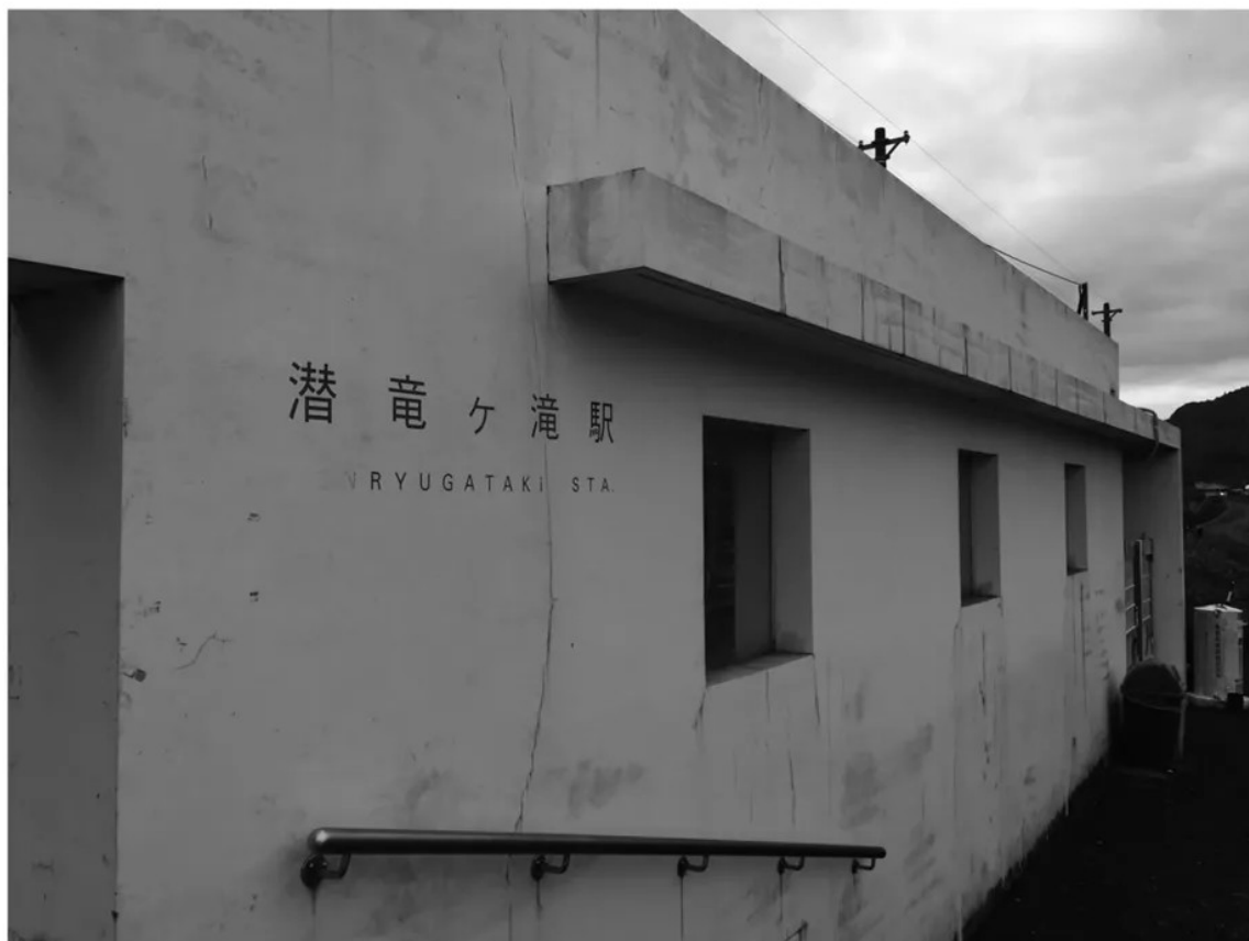
▲2015年12月5日 主催撮影 打ちっ放しのコンクリートは罅割れ、表面には経年劣化が目立つ。
